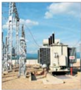
Electrica Moldova a pus în funcțiune noua stație electrică realizată de ABB
